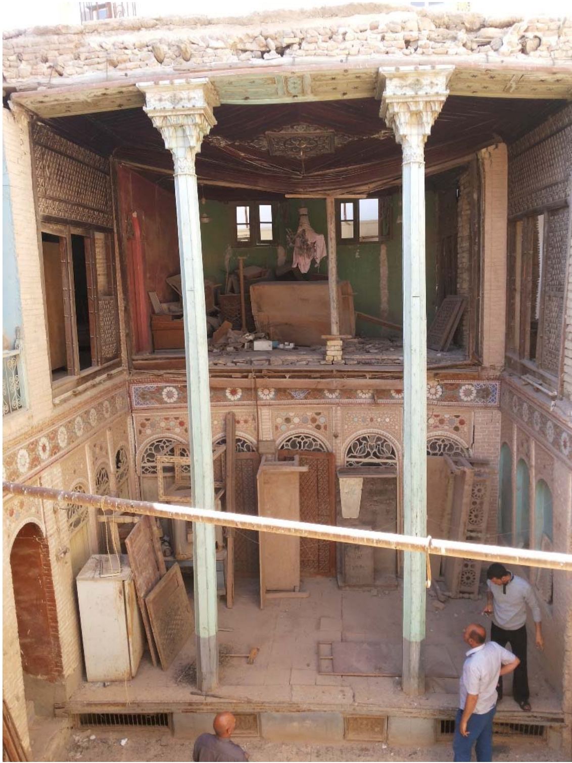
Figure 269 : cl. Exemples des poteaux en bois nommés al-Dalak (IAPN) dans la maison d' al-Mulla Najam
