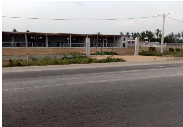
Photo19: Gare moderne de transport en commun inter urbain à Jacqueville en construction
