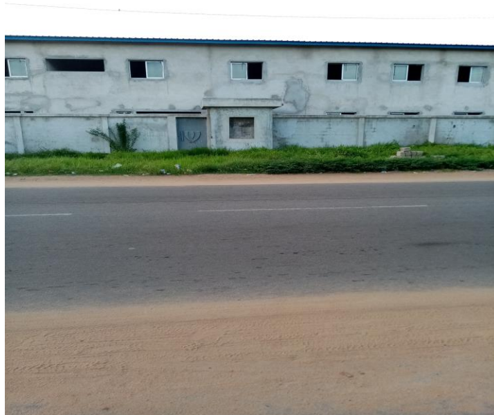
Photo25: Bâtiment du commissariat de police en construction inachevée et non fonctionnel à Jacquville
