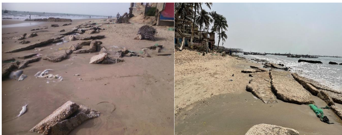
Planche de photos 49 : Destruction du mur de protection du campement la nature (Bocoum, février 2022).
