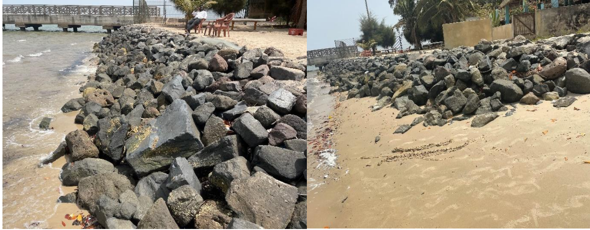
Planche de photos 51 : Enrochements devant le campement Barracuda de Carabane (Bocoum, mars 2022).
