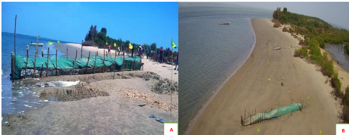
Planche de photos 54 : Construction d'épi sur la flèche de Kafah à l'Ouest (Chevalier, 2019).
