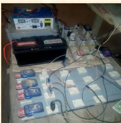
Planche 3 : Dispositifs de recharge de batterie dans la zone d'étude
