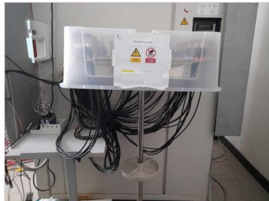
b) Vue des connectiques à l'extérieur de l'enceinte
