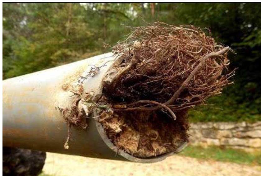
Figure 120: Un drain endommagé par des racines d'arbres (Terre et Cité, 2023)
