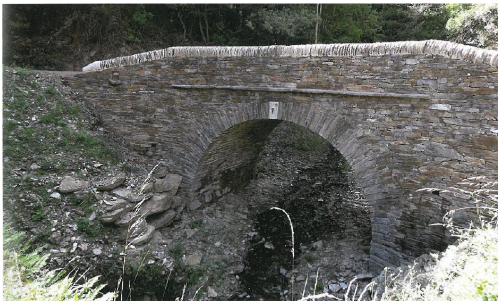
Figure 1.4 : Pont en limousinerie (maçonnerie de pierre avec mortier de chaux faiblement dosée) construit en 2012 à CHALDESCOSTE, maître d'ouvrage : mairie de St Andeol de Clerguemort ; maîtres d'œuvres : entreprises de l'association ABPS (Artisans Bâtisseurs en Pierre Sèche)
