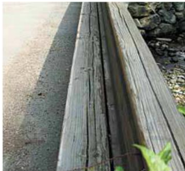
Figure 31 – Fentes sur les lisses d'un garde-corps, créant ainsi des pièges à eau (LCPC, 2008)
