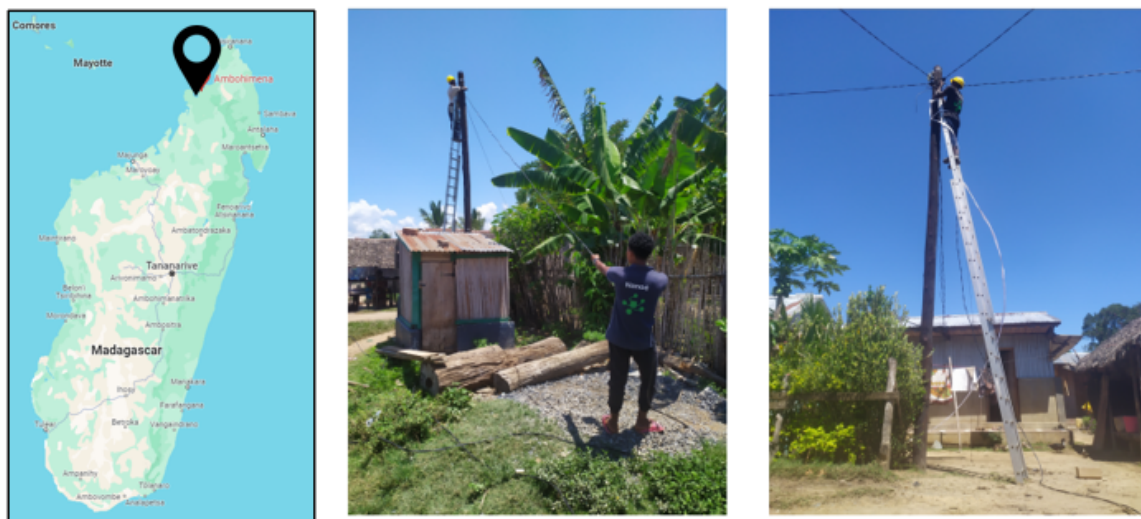
FIGURE 1.19 : Localisation des nano-réseaux DC déployés par l'entreprise Nanoé dans le nord de Madagascar.
