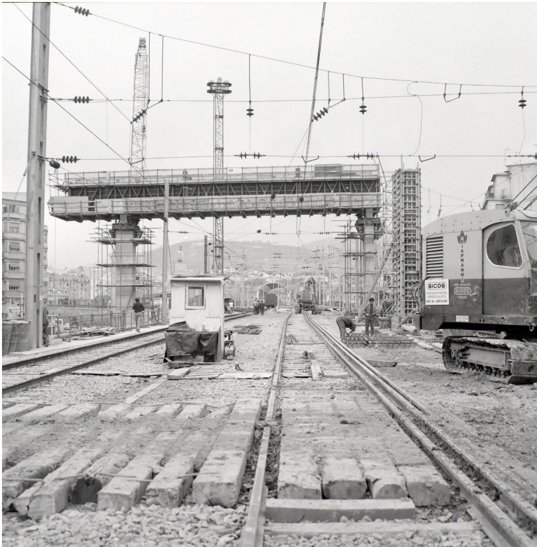
Figure 34. Pose des piliers et des poutres au-dessus de la voie ferrée, à l'ouest de la gare SNCF. AM 860W1972.
