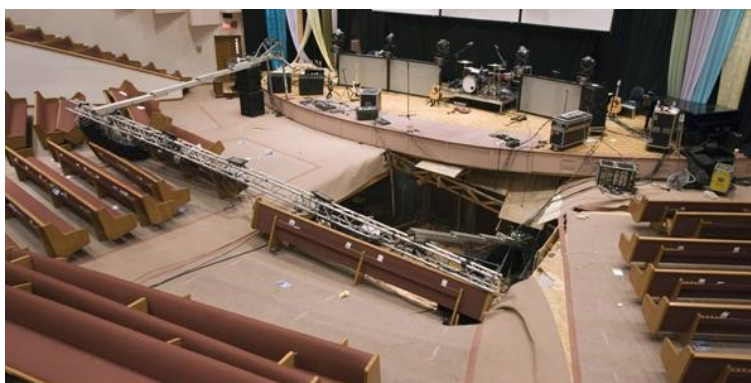
Figure 236 : Effondrement du plancher devant la scène, Canada, 2008, [47]
