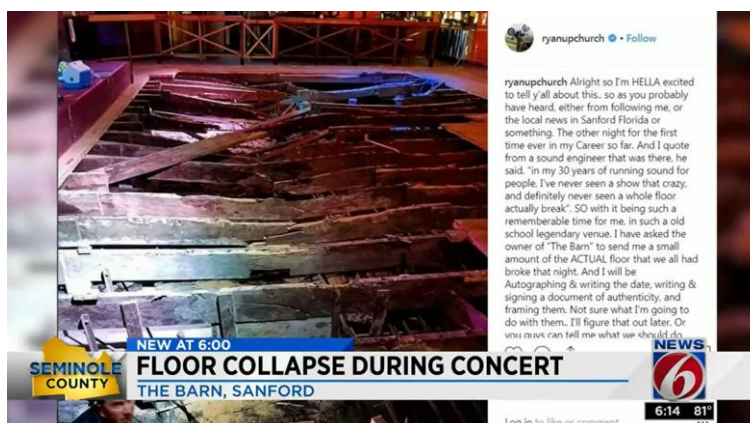
Figure 242 : Effondrement d'un plancher bois dans un bar dansant, Etats-Unis, 2018, [51]
