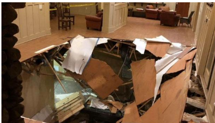
Figure 241 : Effondrement d'un plancher par suite d'une soirée étudiante, Etats-Unis, 2018, [43]
