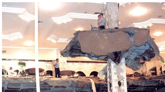
Figure 54 : Effondrement de la piste de danse d'un mariage, Jérusalem, 2001 [44]
