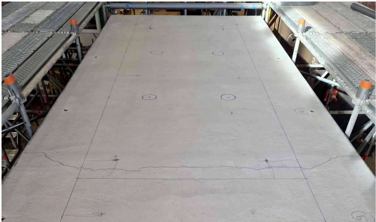
Figure 250 : Fissures ouest entre les dalles 9 et 10
