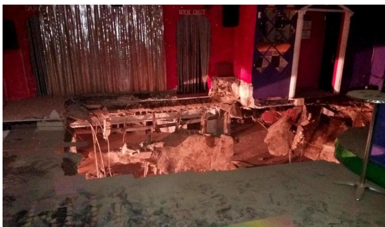
Figure 239 : Effondrement de plancher de discothèque, Ténérife, 2017, [45]
