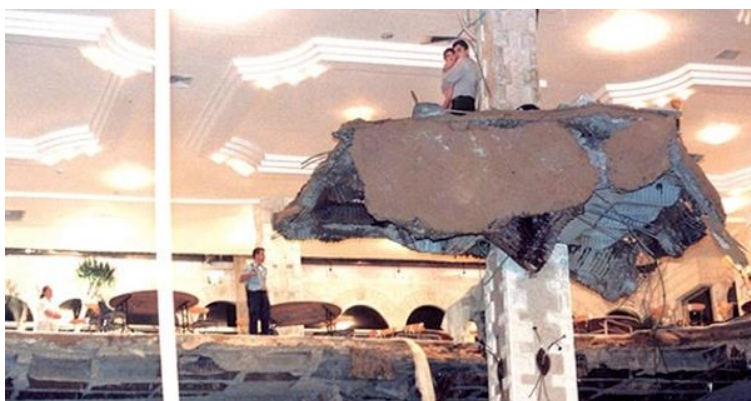
Figure 235 : Effondrement de la piste de danse d'un mariage, Jérusalem, 2001, [44]
