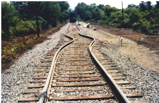
FIGURE 2.2 • Flambement d'un rail de chemin de fer sous forte chaleur 1
