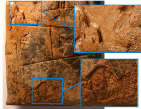
Cas où la couche supérieure s'est effritée localement
