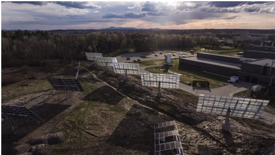
FIGURE 1.5 – Photo du champ de traqueurs du 3iT à Sherbrooke supportant des panneaux à concentration
