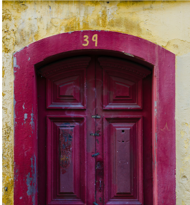
FIGURE 1.25 – Mur et porte usés.
