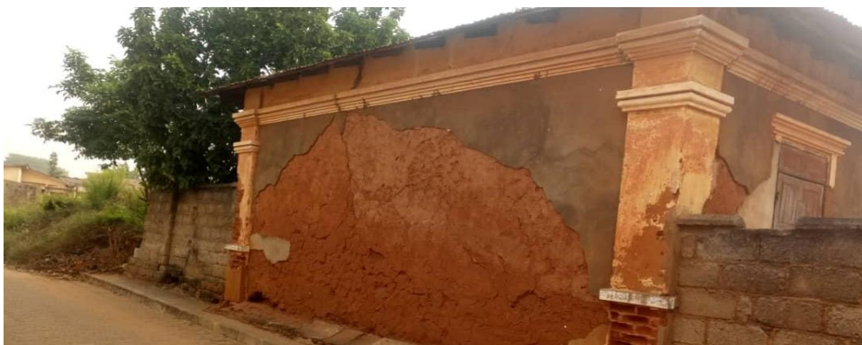
Figure 10 : Pan de mur en dégradation (maison afro-brésilienne à Ouidah)
