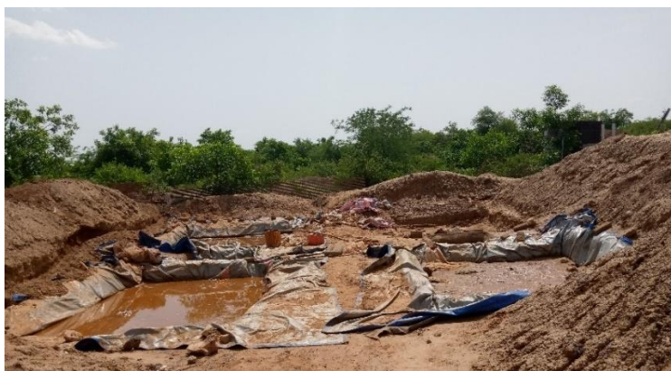
Figure 9. Photographie d'un bassin de cyanuration (Yamma,2021)
