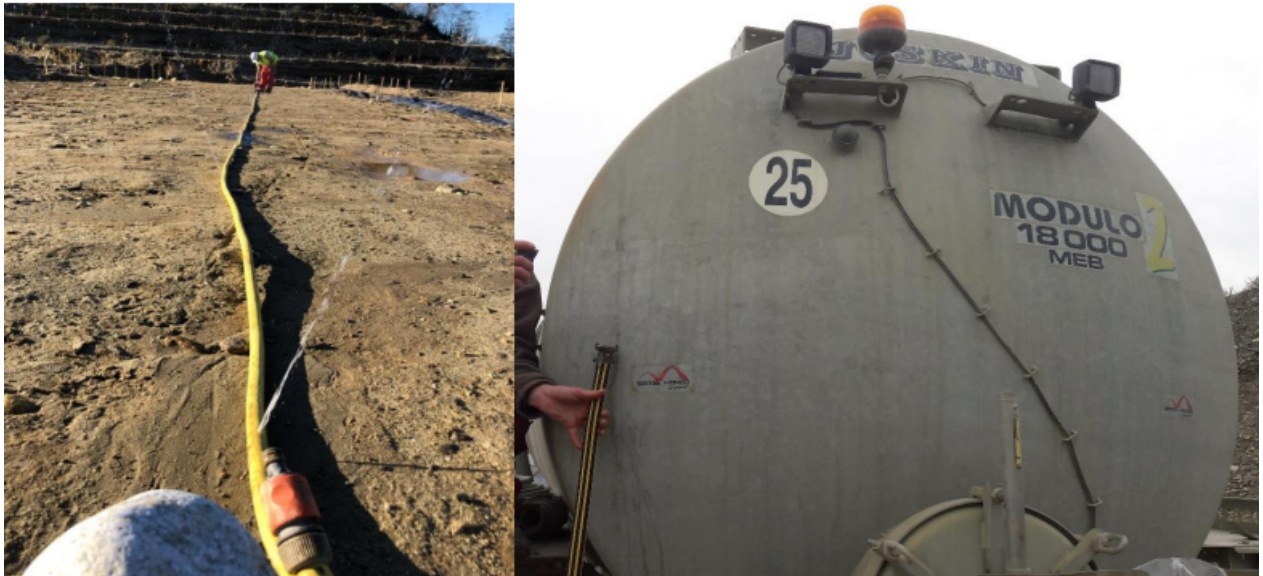
FIGURE 1.15 – Système d’arrosage de la tranchée de sable sec : tuyau percé et citerne de 17 m 3
