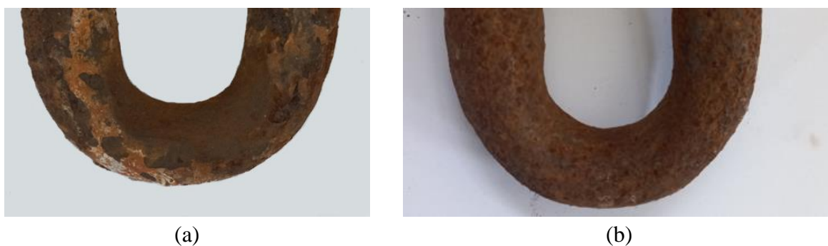
Figure I-50 – Usures dans des cintres de chaînes dont les rotations axiales sont autorisées. Mailles ayant servi à l'ancrage de bouées de signalisation maritime.
