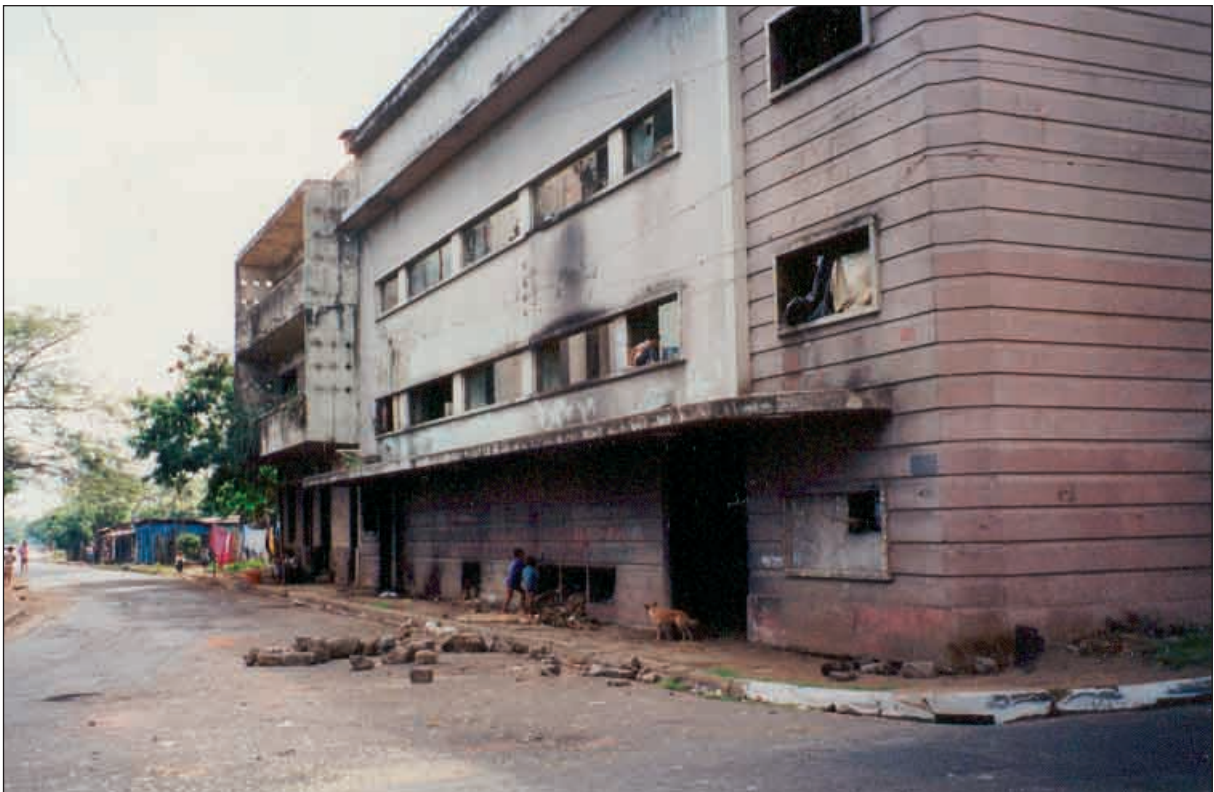
Photographie 21 - Un immeuble en béton resté debout après le tremblement de terre du 23 décembre 1972. Il a été réinvesti par les couches très pauvres de la population, qui souhaitent profiter non seulement de la situation centrale du lieu, mais aussi d'un toit en dur, gratuit, et de certains des services urbains dont bénéficiaient le centre colonial (réseau d'égout et pluvial). A l'arrière-plan, on trouve un établissement spontané qui s'est installé sur les parcelles nettoyées après 1972 (Cliché : S. Hardy, 1999)
