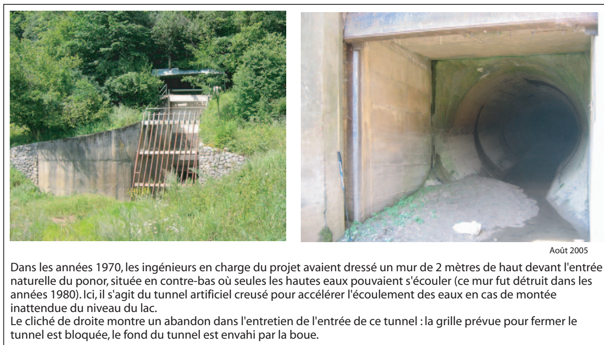
Figure II.42 : Projet de lac permanent sur le site du poljé de Cerknica (1960-1970) : traces des aménagements réalisés au niveau d'un des principaux ponors (Velika Karlovica), Août 2005
