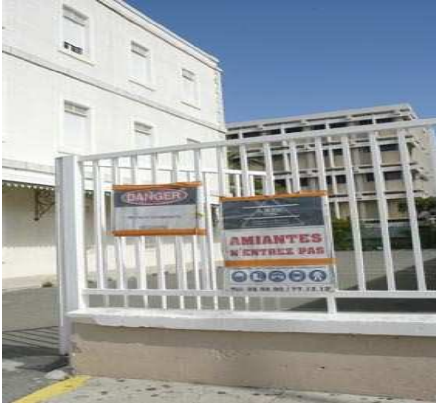
Photographie 112 : Désamiantage du Collège Beaudoux – Nouméa – en 2006, sous l'égide de la province Sud (Photo Les Nouvelles calédoniennes)
