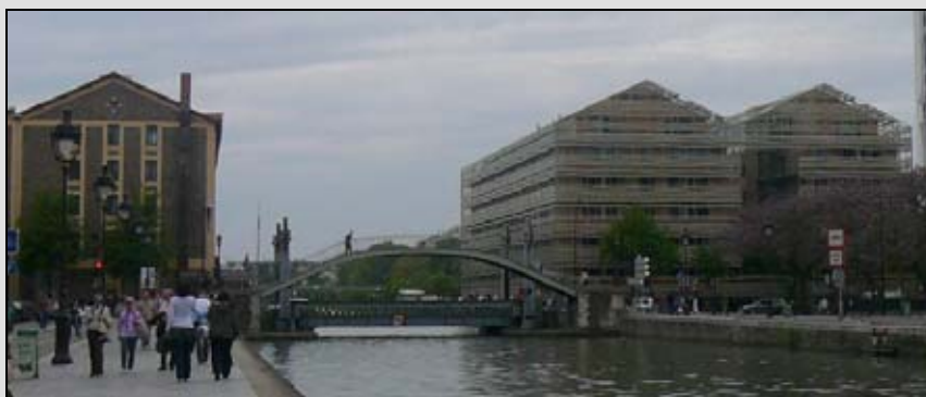
Image 147. Les anciens Magasins généraux du bassin de la Villette rénovés et reconstruits (vus du nord, avril 2008)
