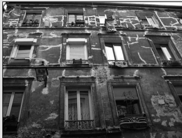
Image 34. Un immeuble à la façade colmatée au plâtre rue Sainte-Marthe (mai 2005)
