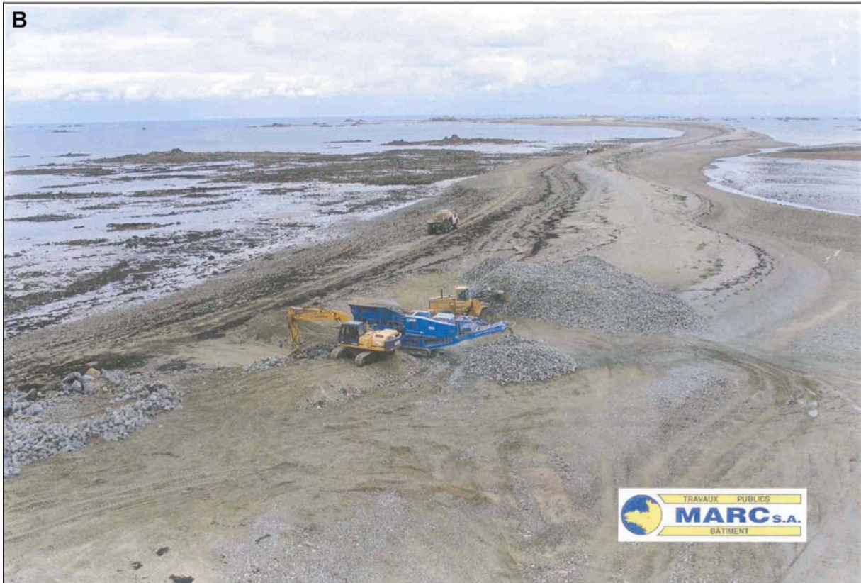
Photographie 42 : Travaux de suppression de la digue frontale en enrochement sur le Sillon de Talbert (cliché A : D. Halleux, octobre 2004 ; cliché B : Société Marc)
