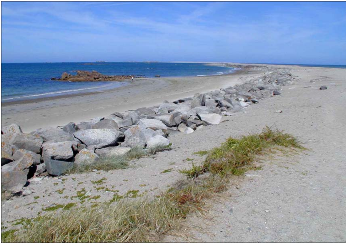
Photographie 41 : Digue frontale en enrochements mise en place en haut de cordon le long du Sillon de Talbert (Cliché : D. Halleux, 2003).
