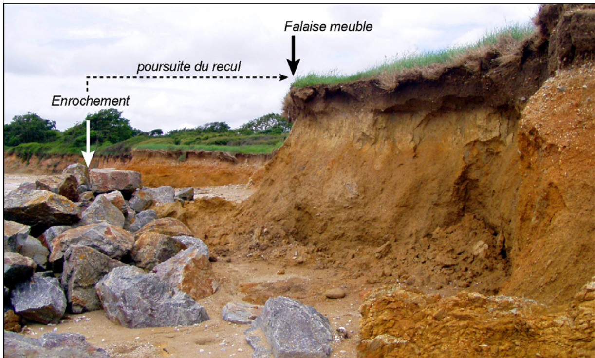
Figure 155 : Inefficacité de l'enrochement mis en place à la fin des années 1990 à la base des falaises de Cromenach (anse de Bétahon) pour empêcher leur recul.
