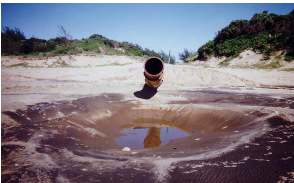
Photo 78 : La conduite après « l'éruption »
