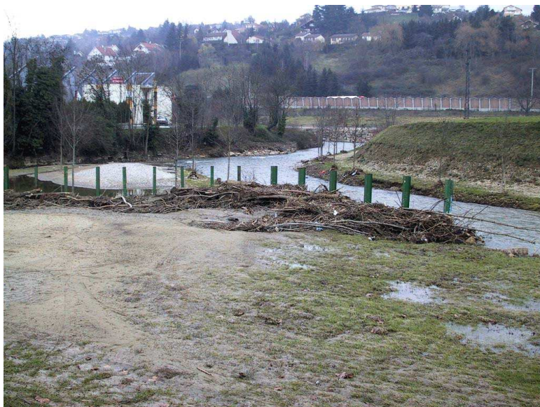
Photographie 9 – Le piège à flottants de la commune de Bourgoin-Jallieu (Isère), sur la Bourbre (cliché : M. Boyer, 2003).
