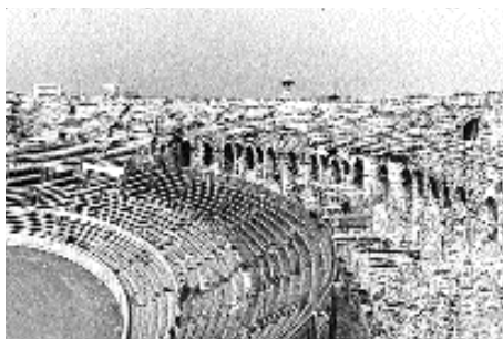
Fig. 484. Les degrés inférieurs des Arènes de Nîmes recouverts de planchards et les échafaudages en tubulure dressés en différents endroits dans les parties hautes. (Phot. Office du tourisme, Nîmes.)
