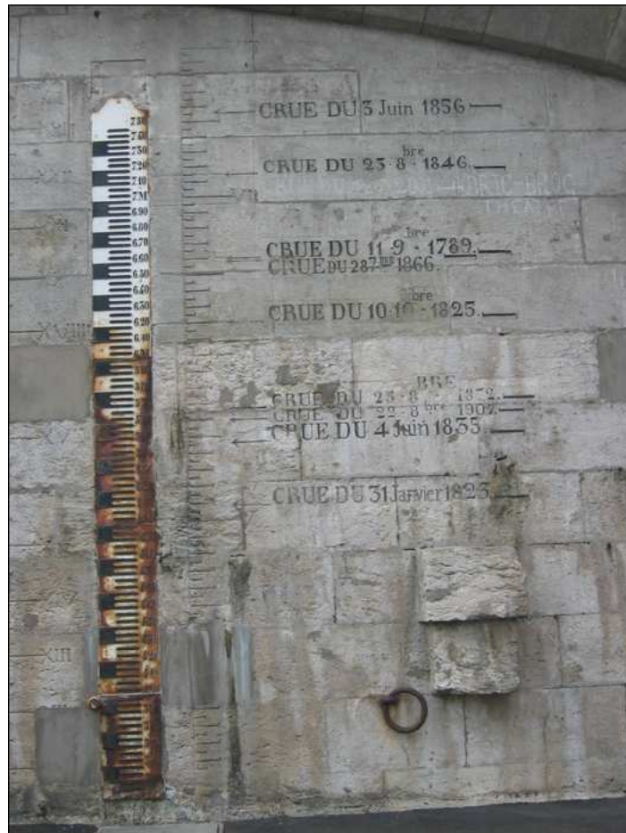
Photo 1.4 : Echelle de crue sous le pont Wilson à Tours
