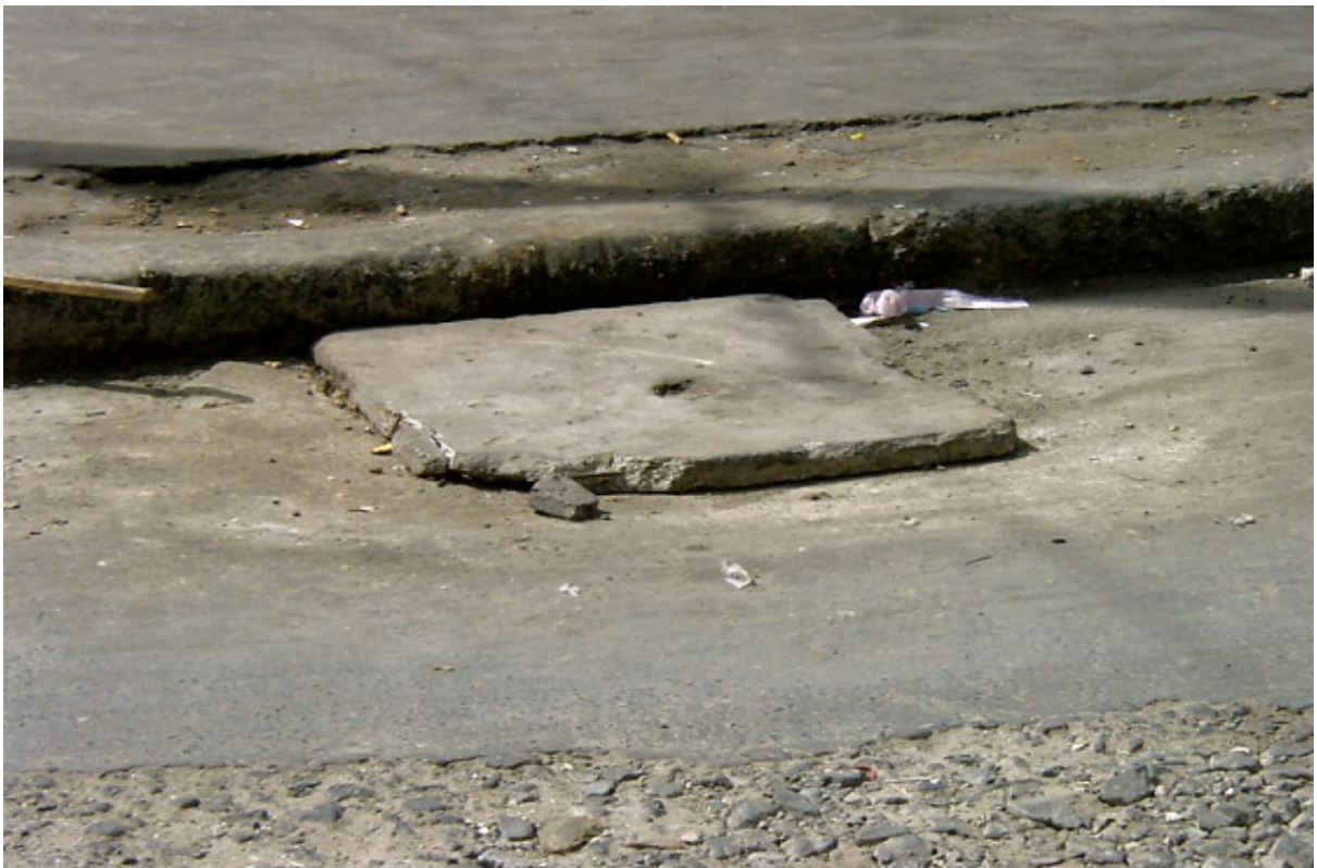
Photo 67. Trappe cimentée mise en place par les populations pour pallier le vol des grilles avaloirs. De petits interstices sur les côtés permettent de laisser passer les eaux de ruissellement tout en retenant les débris solides contenus dans les fluides résiduaires rejetés par les populations. (Cliché DIAWARA A-B 2007).
