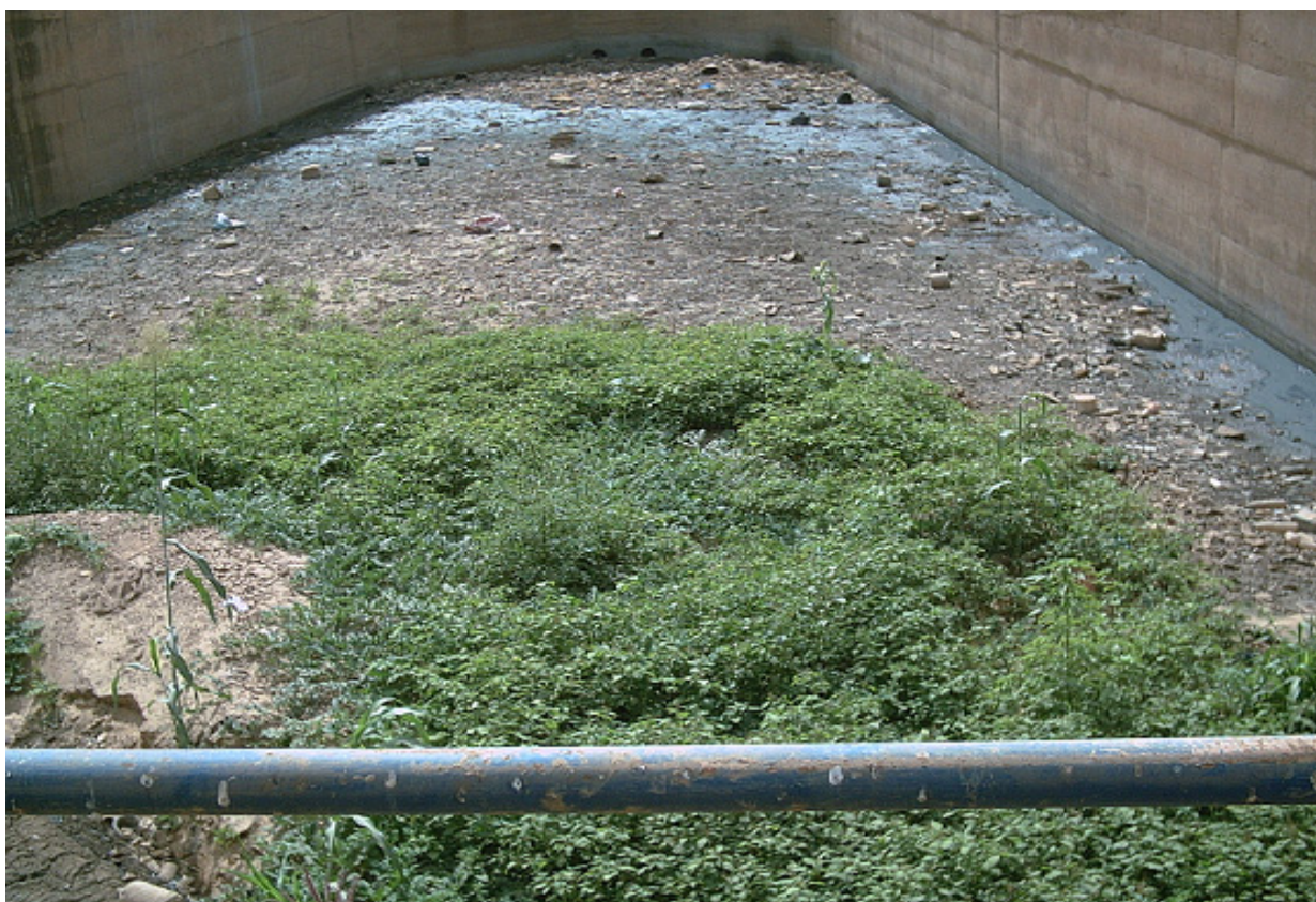
Photo 62. Collecteur d'eaux pluviales de Grand-Yoff. Réalisé récemment, l'ouvrage est régulièrement colmaté par une végétation « colonisante », des eaux usées domestiques et des déchets solides qui y sont déversés illégalement. (Cliché DIAWARA A-B 2007)
