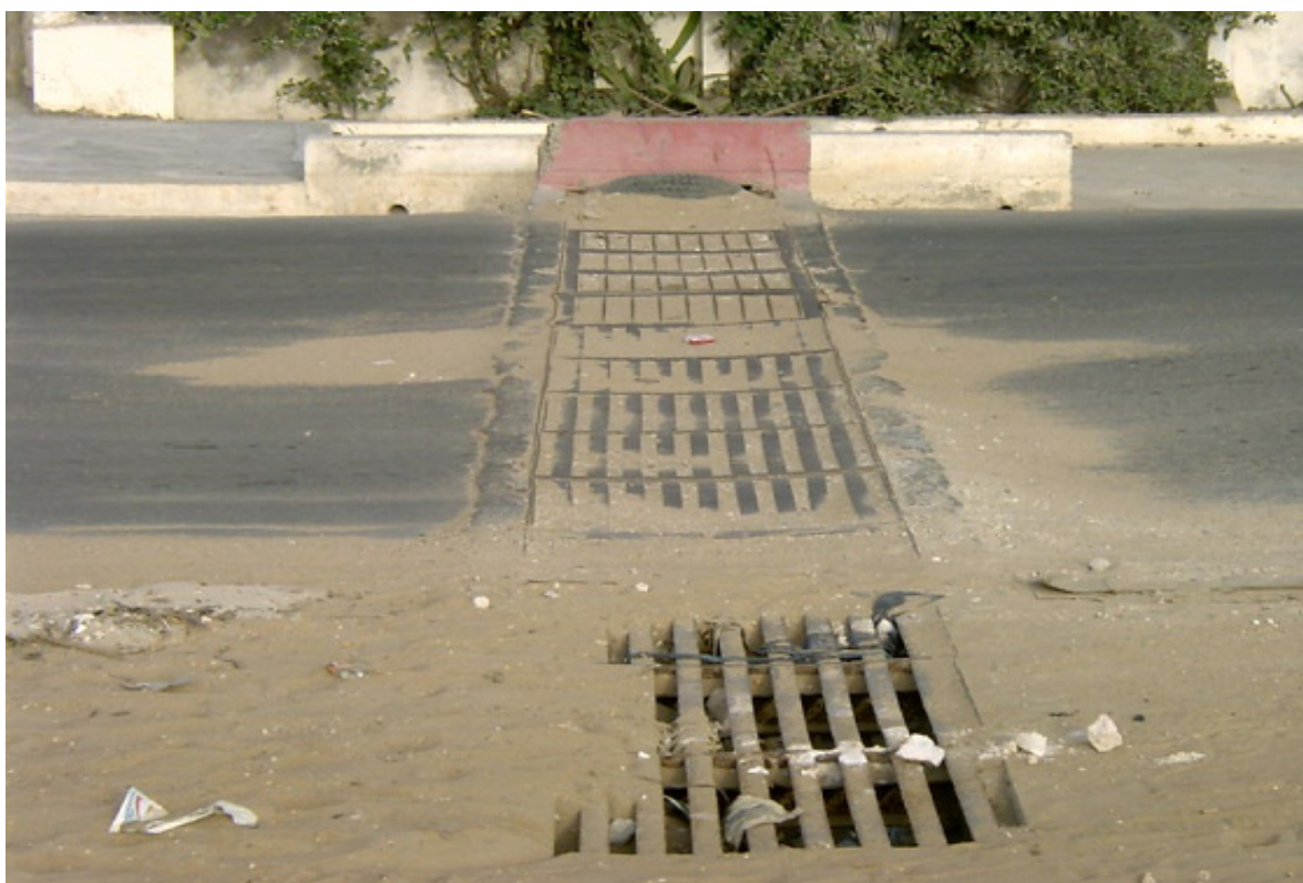
Photo 57. Grilles avaloirs du réseau pluvial progressivement ensablées sur la VDN à hauteur de Mermoz. (Cliché DIAWARA A-B 2007)
