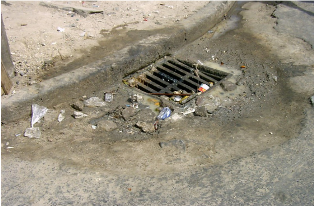
Photo 64. Grille avaloir destinée à l'évacuation des eaux pluviales à la Médina et colmatée par les débris et les fluides résiduels d'origine ménagère. On remarque un début de dégradation de la chaussée sur le pourtour de la grille. (Cliché DIAWARA A-B 2007)
