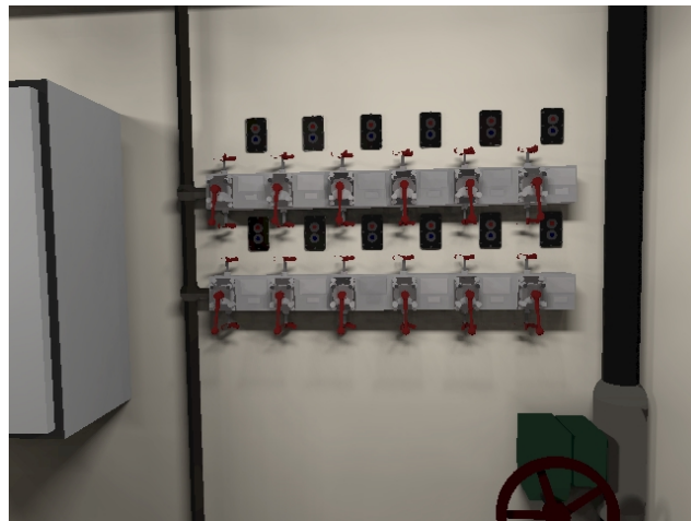
Ensemble de vannes
