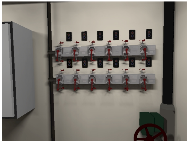
Ensemble de vannes
