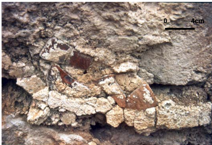
Fig.III.32. Tessons de céramiques centimétriques dans le mortier d'un enduit extérieur, autel du temple hellénistique du sanctuaire de Zeus (Jerash).
