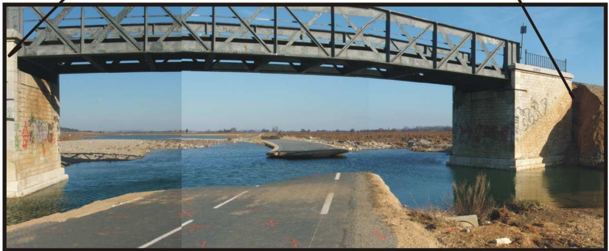
B : Remblai RFF détérioré et route coupée suite aux inondations de janvier 2006
