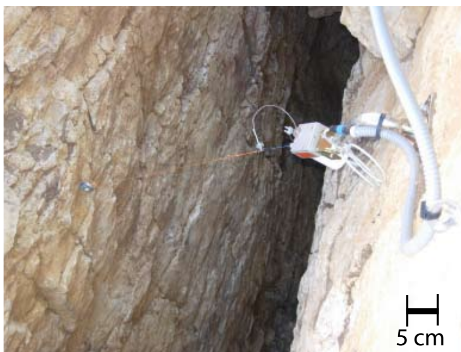
FIG. 1.7: Photographie d'un extensomètre à câble installé sur le site de Chamousset1 (voir chapitre 2) prise en août 2007. Le fil invar orange est tendu entre les 2 parties fixes de part et d'autre de la fissure. Les données sont transmises à la station d'acquisition via un fil électrique contenu dans la gaine grise. Photo of a cable extensometer at the Chamousset1 site (see chapter 2) in August 2008. The cable is maintained tensed between the two sides of the fissure. Data are transmitted to the acquisition system through the gray sheath with electric wire.
