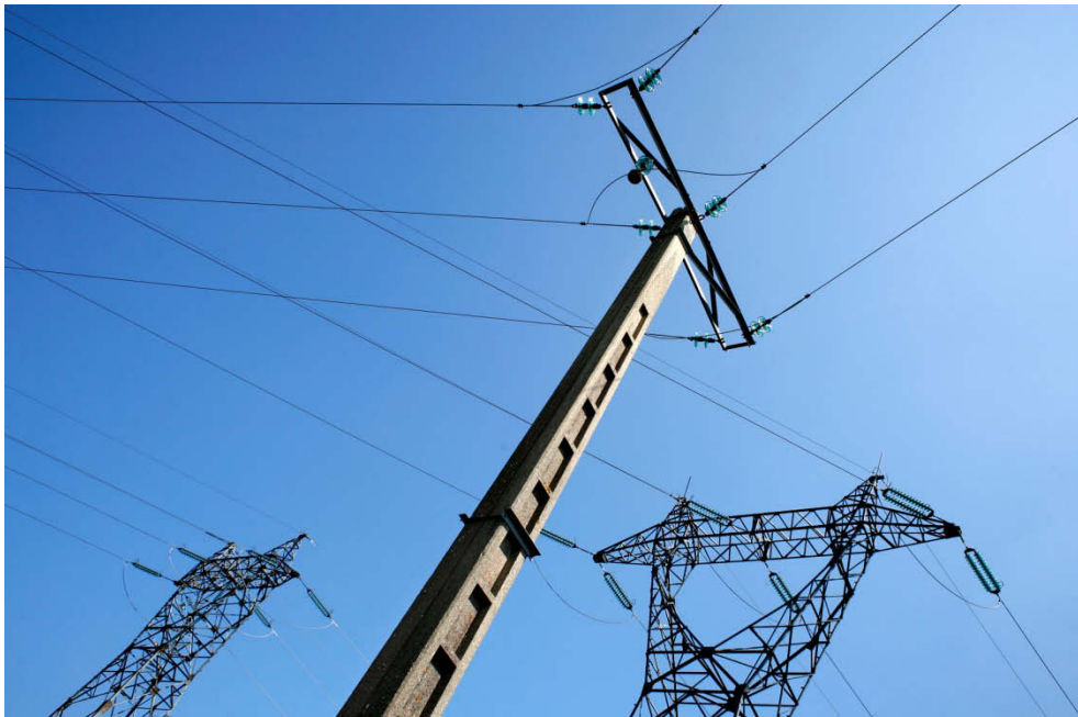
Image 59 Pylône du réseau de distribution 20 kV. Au premier plan, pylône « 3 fils » classique du réseau de distribution de 20 kV parcourant les campagnes, au départ du poste d'interconnexion de Vielmoulin. © Samuel Challéat, ThéMA, 2010.
