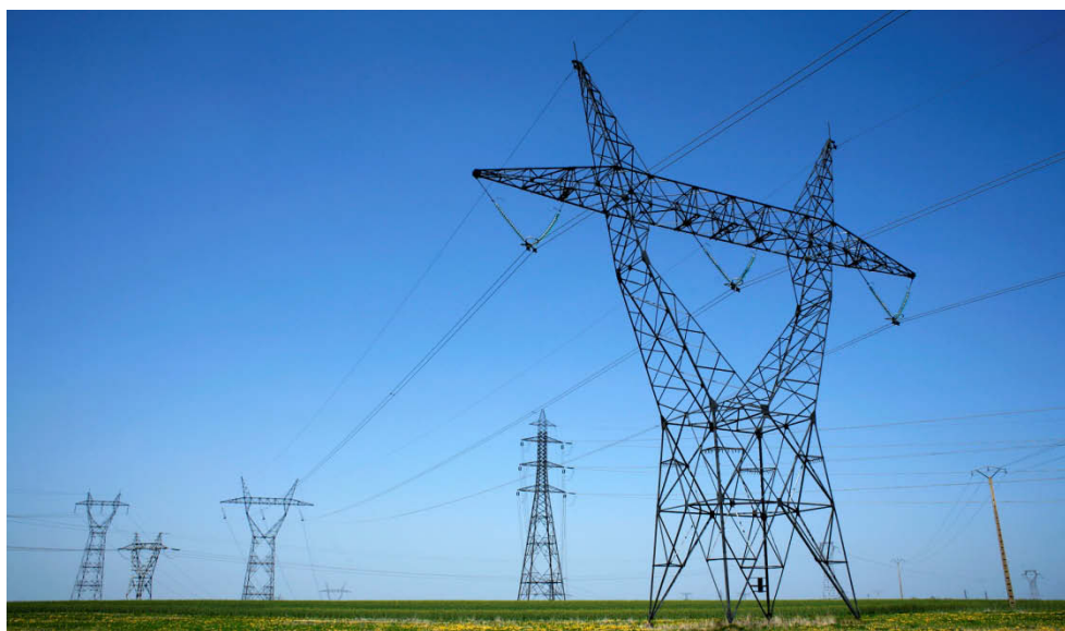
Image 57 Pylône du réseau de grand transport de 400 kV.
