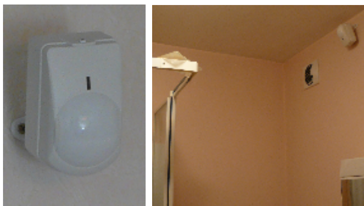
Figure 44- Les capteurs infrarouges installés dans un studio hospitalier au CGS
