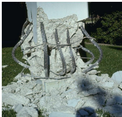
FIGURE 1.2 – Poutre en béton armé en compression : ruine par flambement et rupture fragile.
