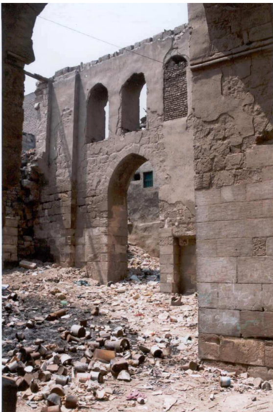
Photo 1-19 : Tas d'ordures dans un édifice historique (hôpital du XVI e siècle aux pieds de la Citadelle). Le monument est en ruine et les ordures qui s'accumulent sont régulièrement brûlées par les populations. ES, 1999.
