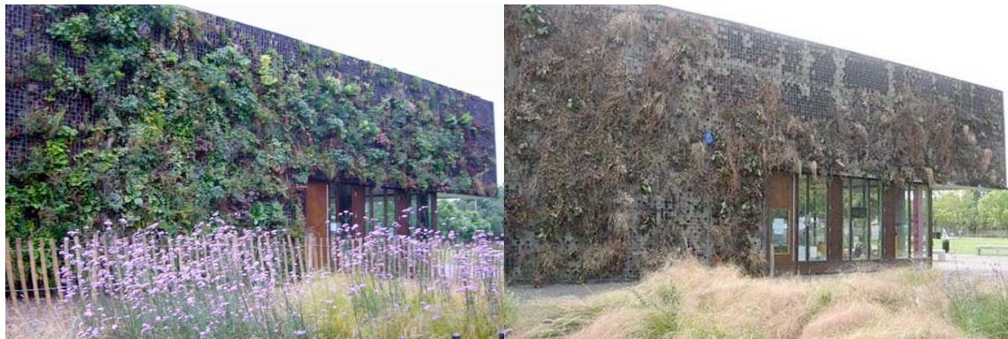
Trois ans après la construction du Paradise Park Children's Center - une crèche londonienne - la « nature » a eu raison du système technique de végétalisation verticale employé pour recouvrir le bâtiment. Si toutes les façades végétales ne subissent pas le même sort, elles ont souvent cet aspect en partie basse, là où le passant ne se contente pas de toucher avec les yeux.
