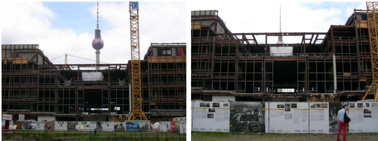
Figure 29 L'exposition « une décision démocratique », aux abords du chantier de démolition du Palais de la République
