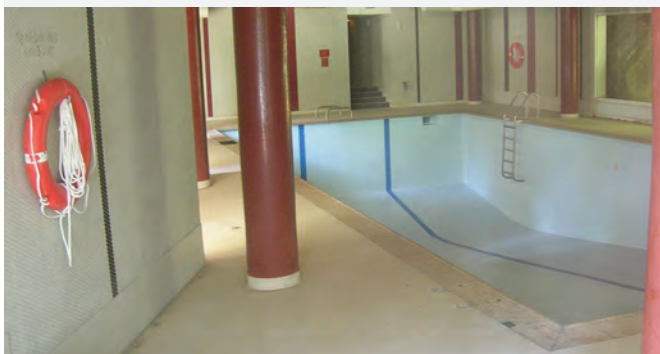
39d. La piscine couverte, hors d'usage
