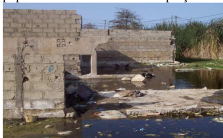
Photo 38 prise en 2009 Des murs soit en construction soit abandon. Présence de roseaux et de l'affleurement de la nappe phréatique dans ces espaces sensibles.
