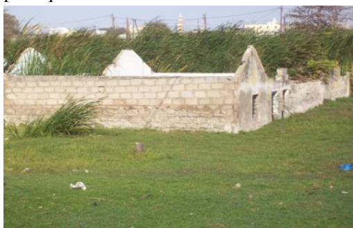
Photo 34 prise en 2009 Une maison abandonnée et construite dans une zone humide maintenant occupée par les roseaux. Au loin on aperçoit des habitations.
