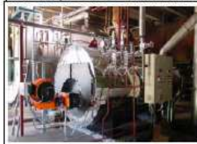
Photo 2 : chaudière biogaz à l'usine
