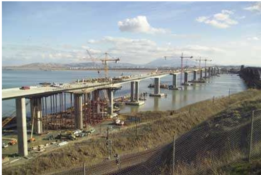
Figure I. 1 : Pont Benicia-Martinez avec du métakaolin dans la formulation du béton (Californie, USA, 2007)
