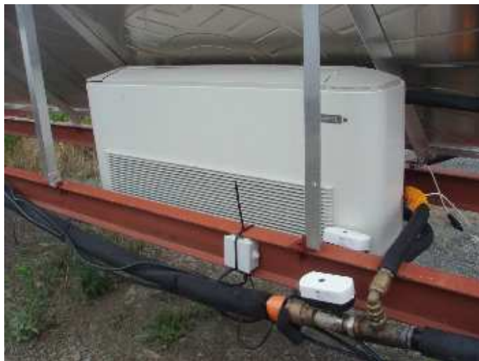
Figure 2.11 – Aérotherme en parallèle du champ solaire
