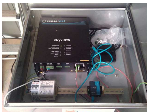
Figure 2.16 – Système d'acquisition des températures du sous-sol (DTS)
