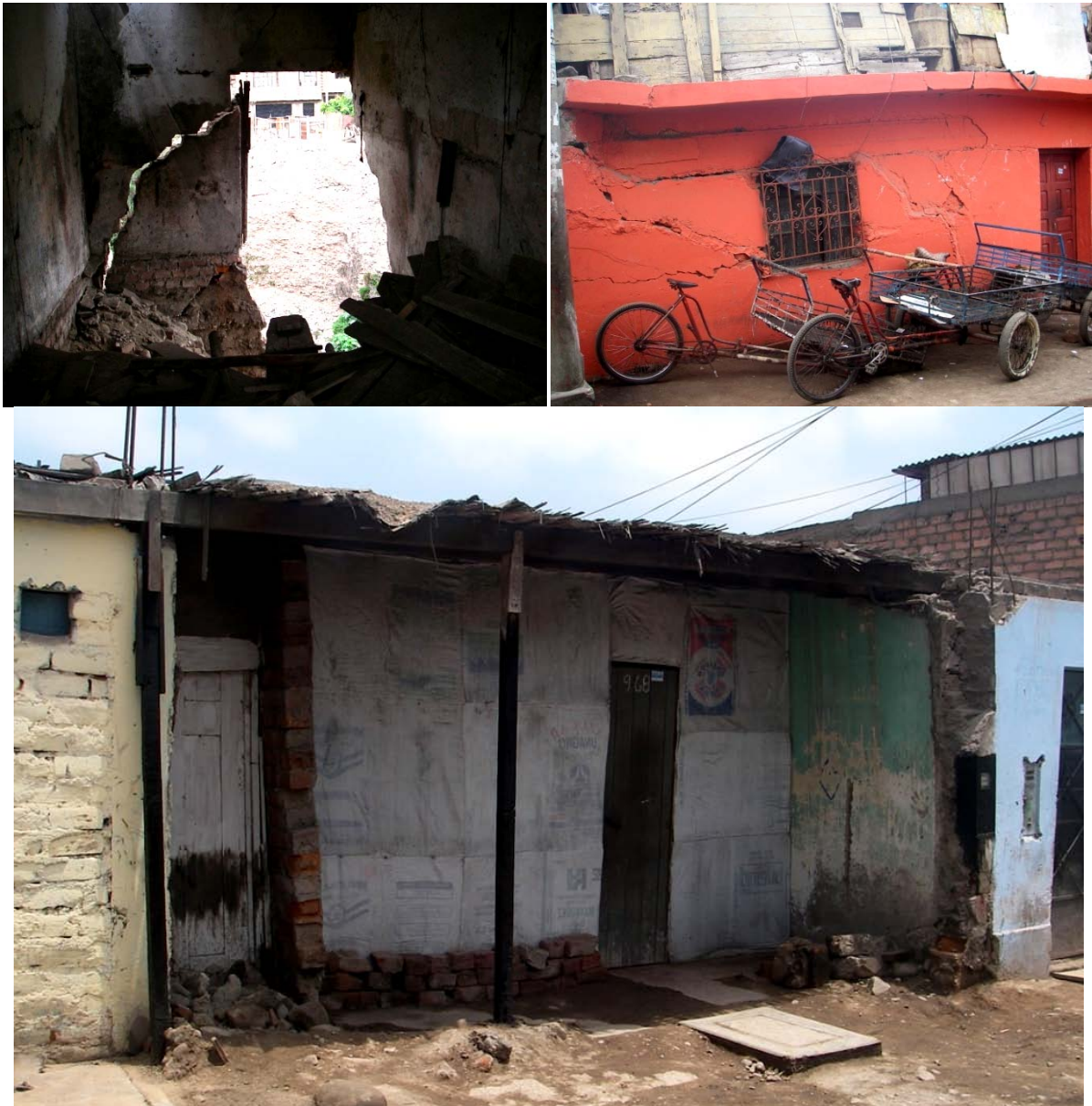
Photos n°21, 22 et 23 : Rive Droite du Río Rímac, maison donnant sur le vide avec la façade effondrée ; maison fissurée construite sur un sol instable dans un secteur d'ancienne décharge ; façade effondrée suite au séisme de 2007 et fermée avec des sacs de jutes en façon temporaire. Source : J. Robert
