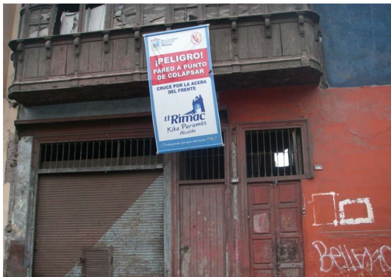
Photos n°72, 73 et 74 : Quintas en adobe et pancarte mentionnant le risque d'effondrement d'un bâtiment (conseillant de marcher sur le trottoir d'en face) au Rímac
