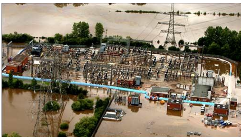
Figure 1.12 : Le poste de transformation de Walham proche d'être submergé.
