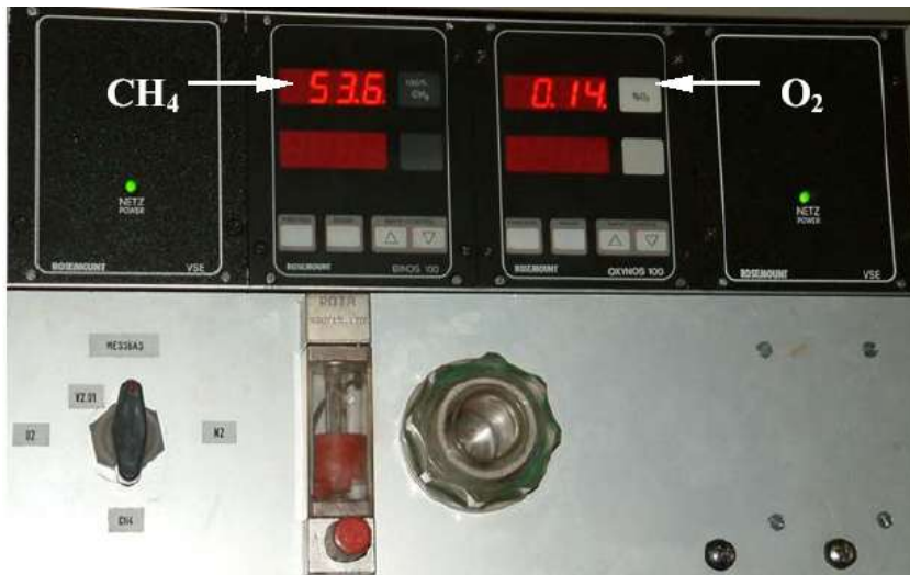
Photo 14. Panel de contrôle des analyseurs BinOS et Oxynos (© Photo M.Meres, UJ-ENSM.SE)
