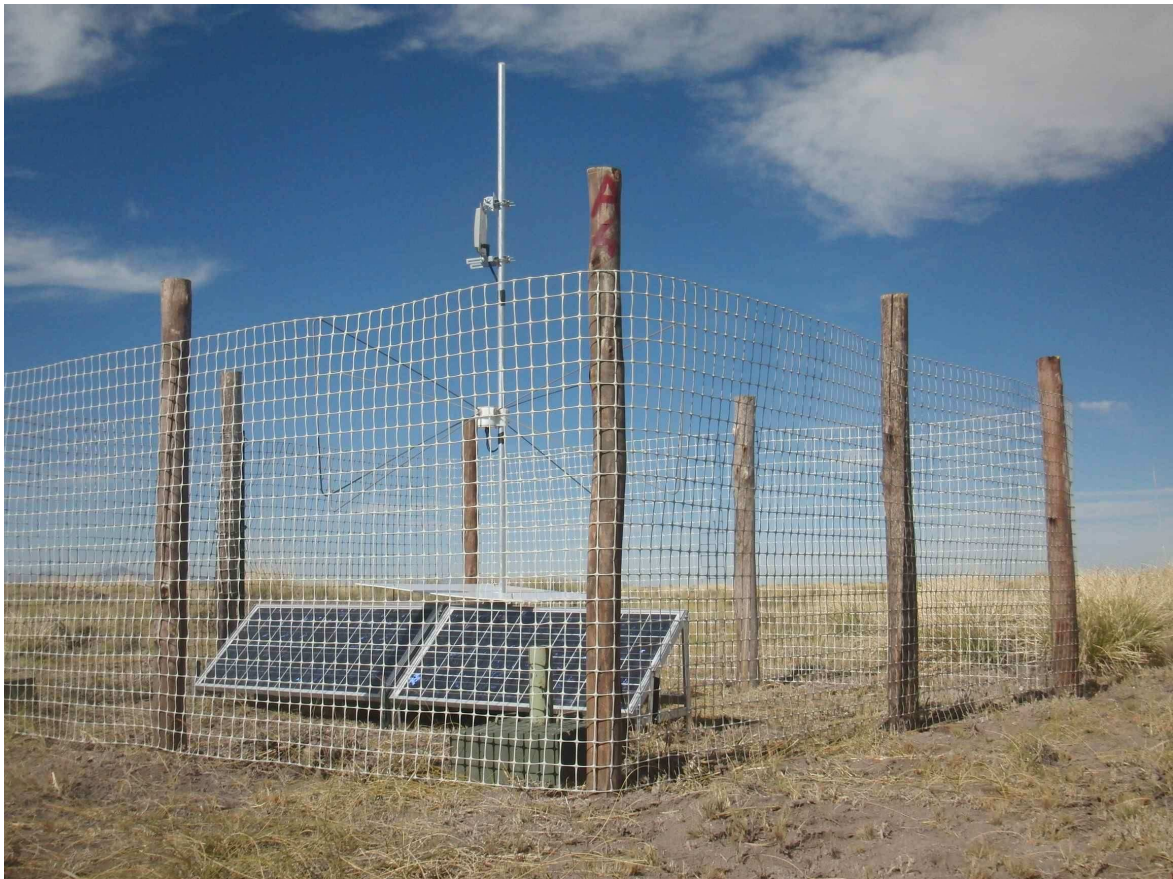
FIGURE 2.51 – Photo d’une station autonome RAuger, avec en premier plan le grillage plastique de l’enclos, en second plan les panneaux solaires puis la station et ses antennes.
